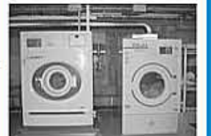
クリーニング業務用の洗濯・乾燥機
